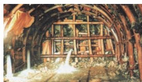
断層によるトンネル湧水
