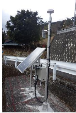
写真-1 GNSS回線集約機 コンクリート擁壁の天端に設置している(写真-1)。
