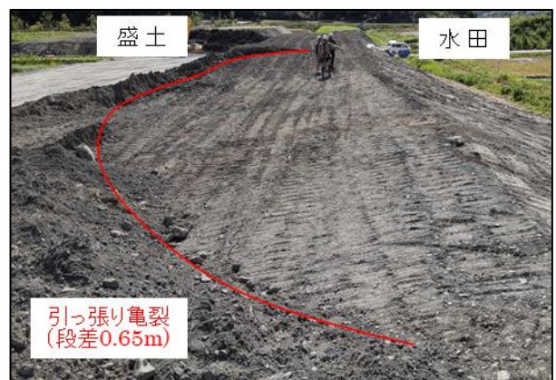
写真-2 盛土背面上に発生した引っ張り亀裂
