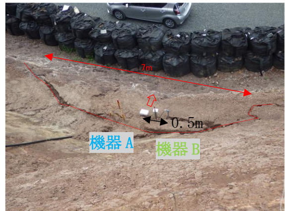
写真-1 表層傾斜計設置箇所
