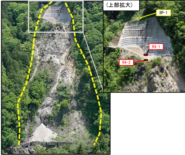
写真-1 崩壊斜面全景 (R5.5 撮影)
