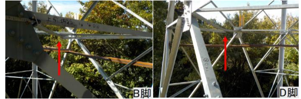
写真-1 鉄塔部材の変形の例
