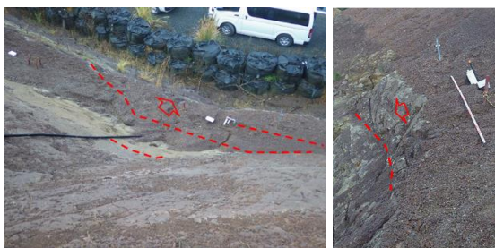
写真-2 変状状況(左:平面、右:断面)
