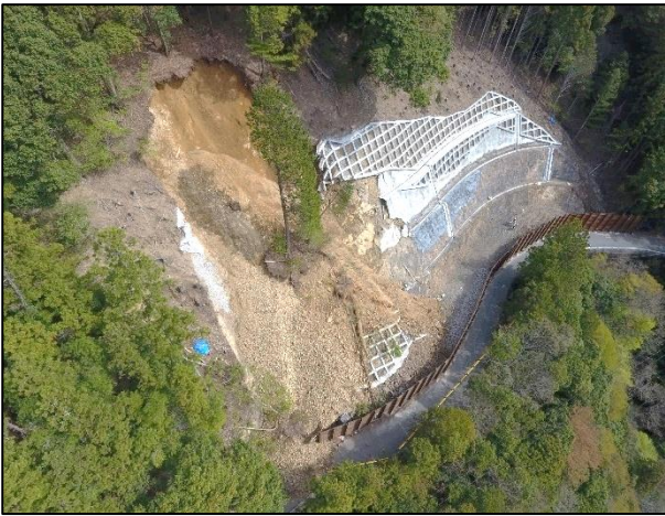
写真-1 長大崩壊斜面の崩壊状況
