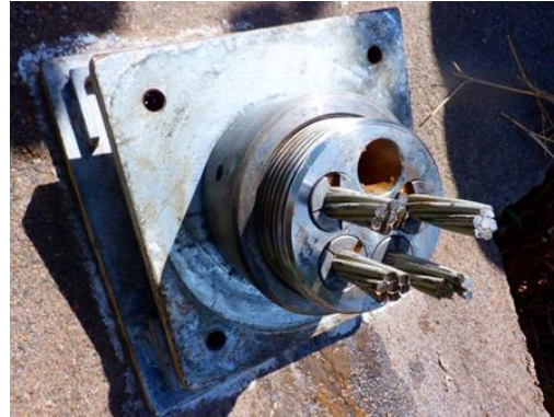
図1 アンカー頭部の錆状況
