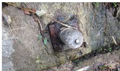
写真-1 変状レベル b 相当の鉄筋挿入工 湧水により、頭部保護材の腐食（錆）を確認した
