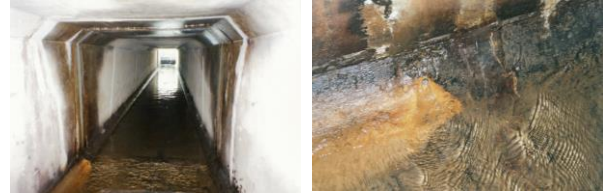
図-2 平成10年頃のクラックと漏水状況
