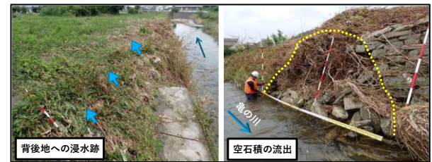
写真-4 3工区の被災状況
