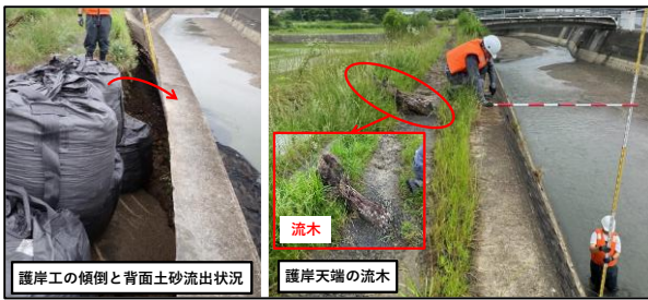
写真-2 1工区の被災状況(2)
