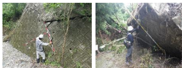
写真-2 上ヶ井地区の被災状況
