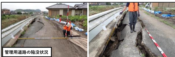
写真-3 2工区の被災状況
