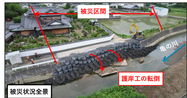
写真-1 1工区の被災状況(1)
