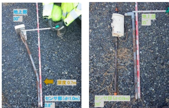
写真-4 変状状況(左:機器A、右:機器B)
