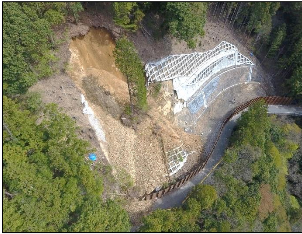
写真-1 長大崩壊斜面の崩壊状況
