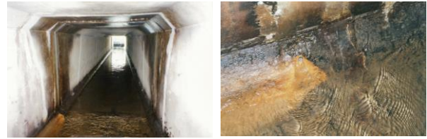
図-2 平成10年頃のクラックと漏水状況
