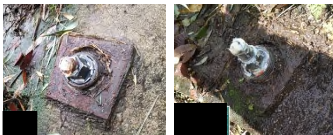
写真-2 変状レベル d 相当の鉄筋挿入工 著しい腐食（錆）と防錆油の劣化・流出を確認した
