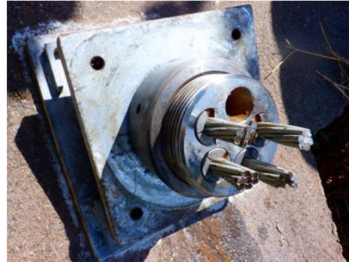
図1 アンカー頭部の錆状況
