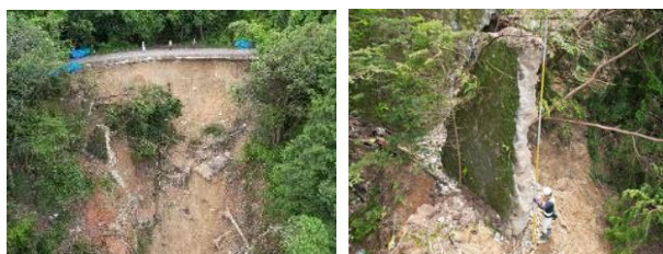
写真-1 別院地区の被災状況
