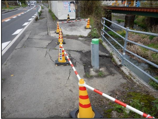
写真-1 路面陥没発生箇所の状況
