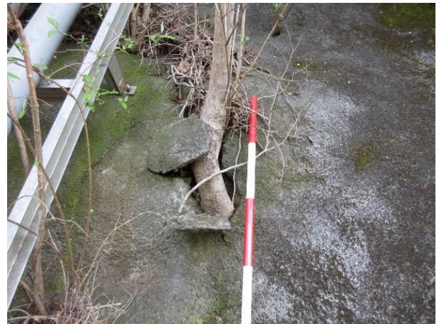
写真-4 モルタル工の経年劣化による剥離およびひび割れ
