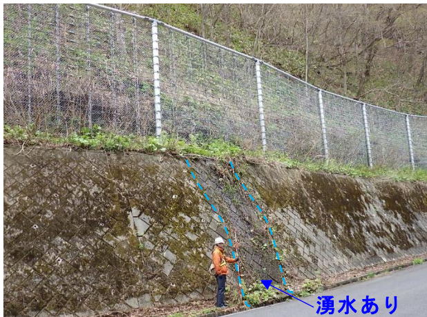
写真-5 斜面末端部の湧水状況
