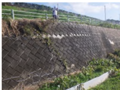
写真-3 擁壁の変状
