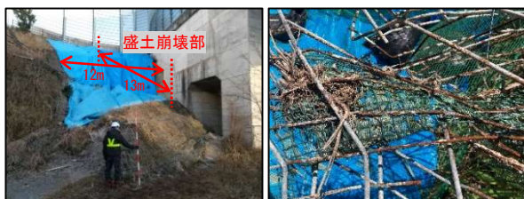
写真-1 崩壊箇所の様子 写真-2 補強土壁の腐食
