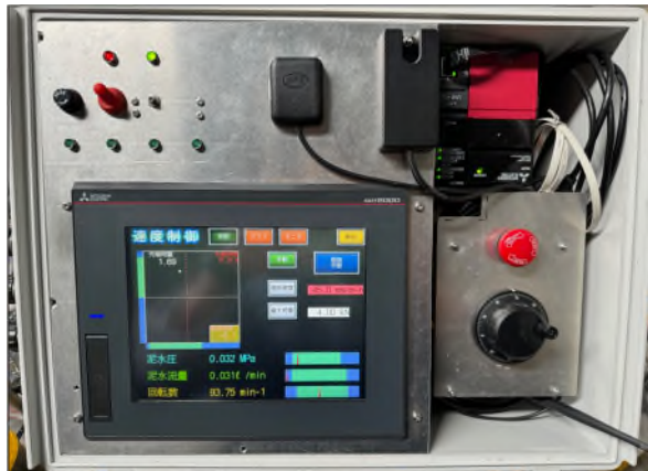
写真-5 制御装置
