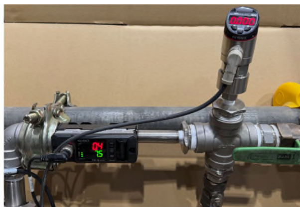
写真-4 送水流量計、送水圧力計
