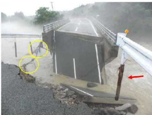
写真-1 被災したA2橋台
