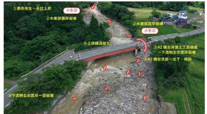
図-7 UAV による被災した橋梁の周辺状況
