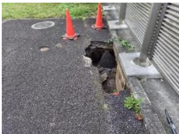
写真-1 陥没箇所状況
