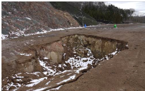
写真-2 排土面に生じた陥没
