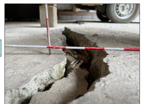
写真-2 家屋駐車場に発生した開口亀裂
