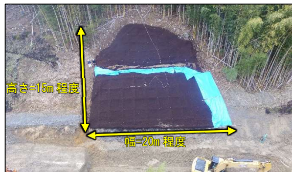
写真-3 法枠工の被災状況全景（事例その3）
