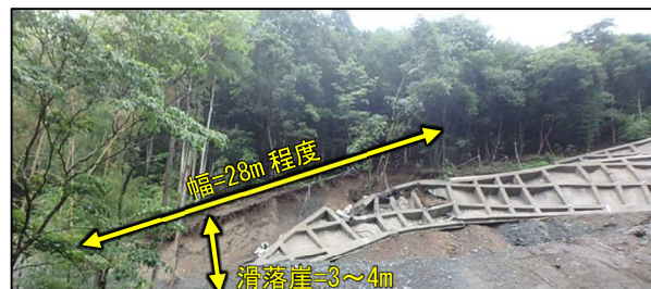
写真-1 法枠工の被災状況全景（事例その1）
