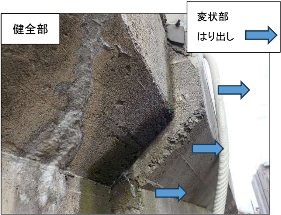
写真-1 擁壁上端部の変状(段差)
