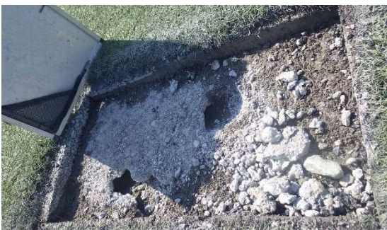
写真-3 再生路盤材の固結および空洞
