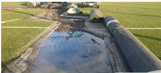
写真-2 人工芝直下の地下水の滞留
