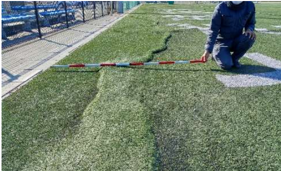
写真-1 人工芝の隆起状況
