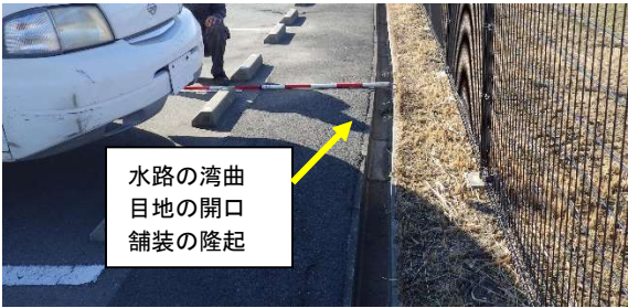
写真-4 水路の変状
