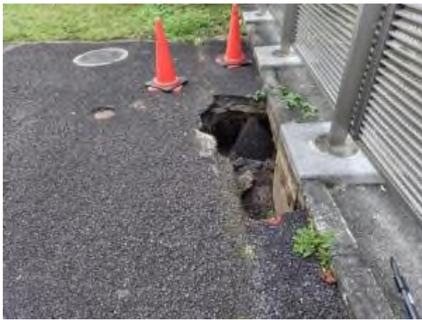
写真-1 陥没箇所状況
