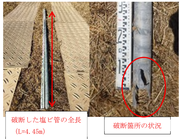
写真-1 破断した塩ビ管
