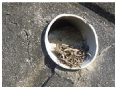
写真-4 水抜き孔
