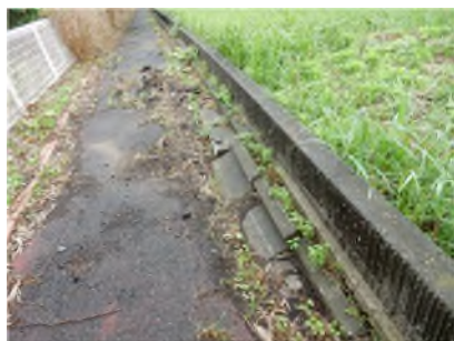
写真-1 法肩部の変状
