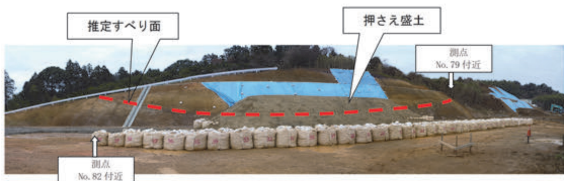
図-1 切土掘削施工中に発生した地すべり変状 応急対策として押さえ盛土工を施工
