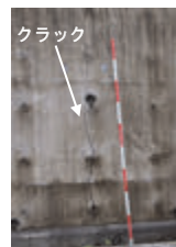
写真3 重力式擁壁のクラック
