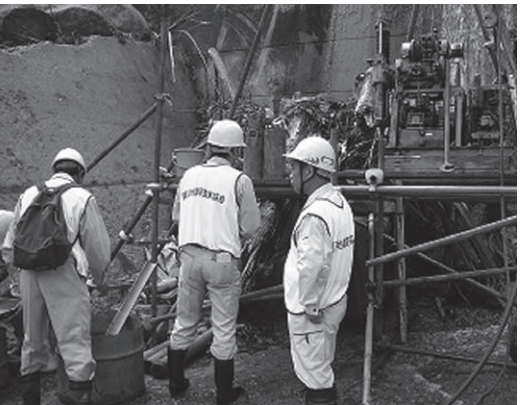
台風12号災害現場（安全パトロールを行う協会理事）
