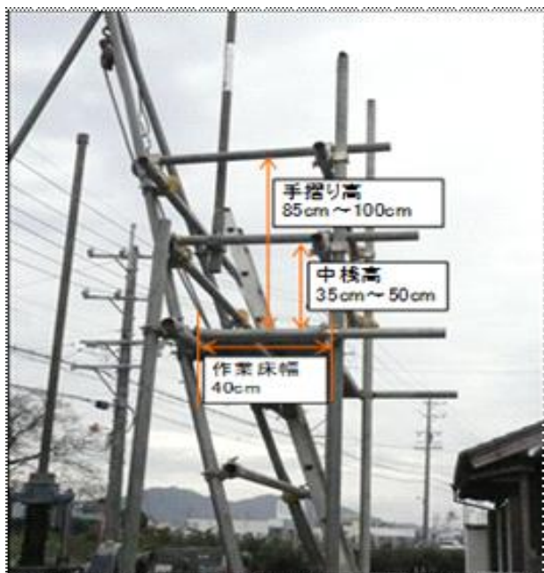
高所作業床 設置例
