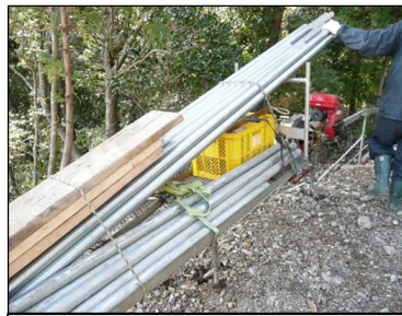
ラック積載物の固縛状況
